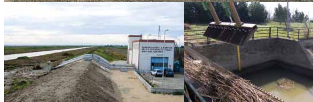
Impianto idrovoro di Cervero (agro di Manfredonia). Tubazioni di mandata in acciaio inossidabile.
