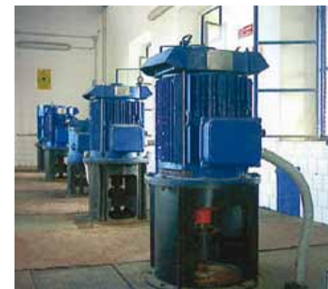
Sala pompe Palude Lauro (agro di Lesina) - motori elettrici ad "inverter".
