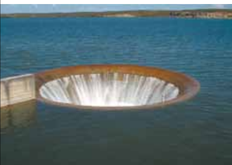
Sfiatore a calice sulla diga Marana Capacciotti.
