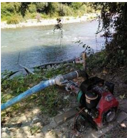
Φωτ 4. Άποψη άντλησης από ποτάμι
