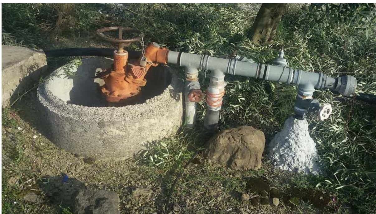
Εικόνα 5 Τυπικό αντλιοστάσιο και τυπική υδροληψία του ΤΟΕΒ Γραμμενίσας – Βλαχέρνας
