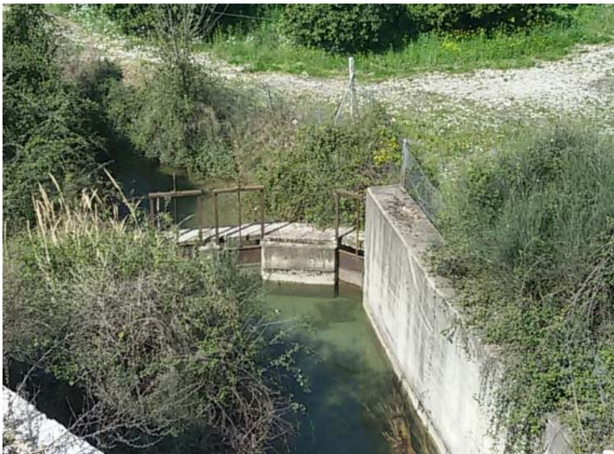
Εικόνα 4 Γενική περιοχή υδροληψίας και υδροληψία του ΤΟΕΒ Γραμμενίτσας – Βλαχέρνας
